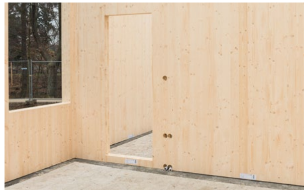
Preparazione per il cablaggio elettrico su tutta l'altezza delle pareti all'interno dei pannelli.
